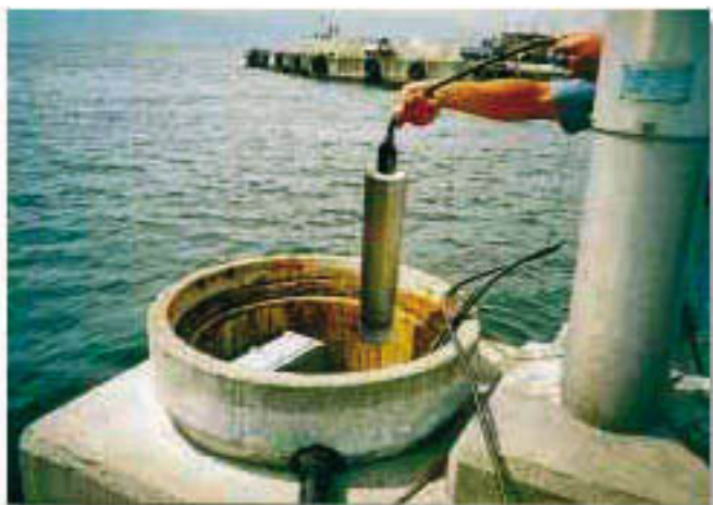
● 水圧式簡易験潮儀センサー部
